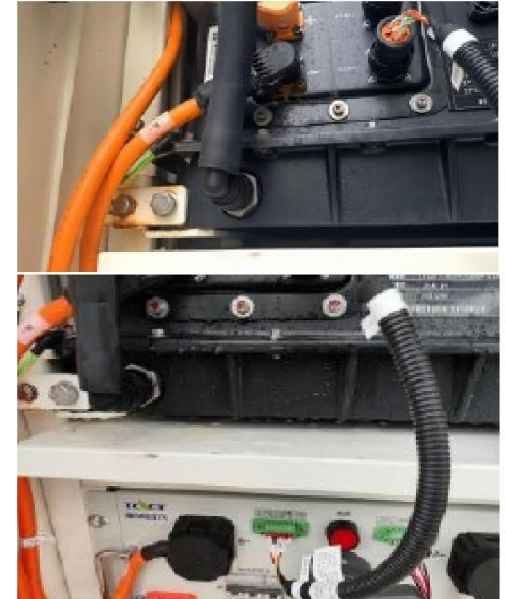
长期凝露,设备腐蚀
