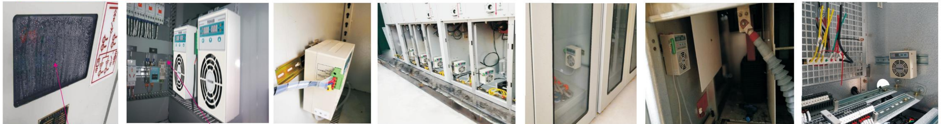
安装前柜内湿度结露
